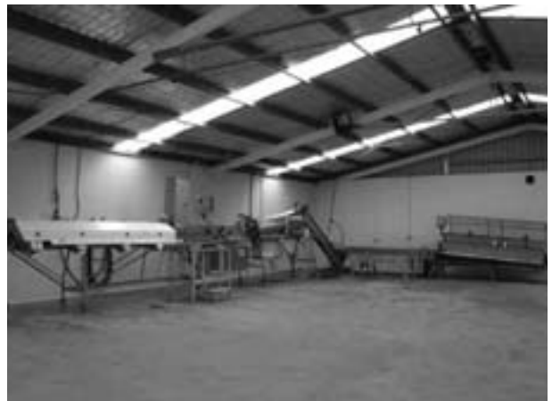
写真 13:いわゆる“grading”用装置。同社の作業棟内
